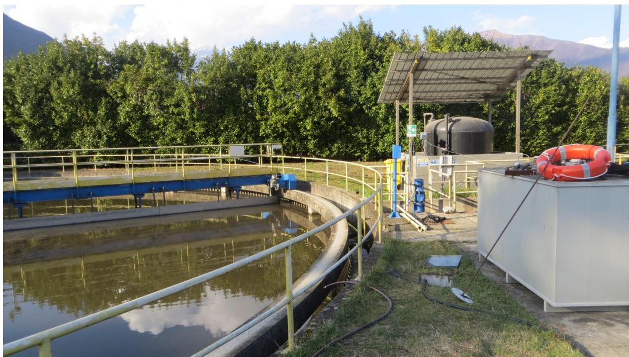
Impianto esistente: sedimentatore secondario esistente
